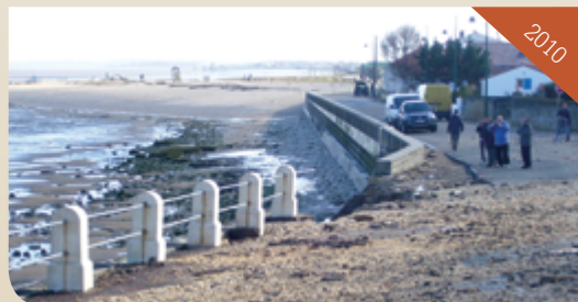
La digue maçonnée de l'avenue de l'Île Madame endommagée après la tempête Xynthia, Port-des-Barques, février 2010.
